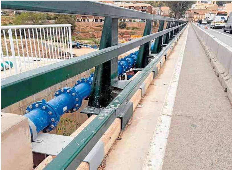
Tubería instalada en el puente del Magro entre las localidades de Real y Montroi. LP
